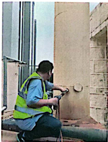
1 号天然气锅炉排气筒
